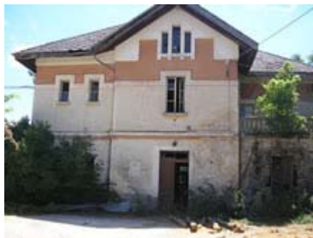
Ex-stazione di Montereale, in stato di abbandono
