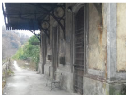
Fabbricato viaggiatori e banchina della ex-stazione di Capriogliola Albiano, in stato di abbandono
